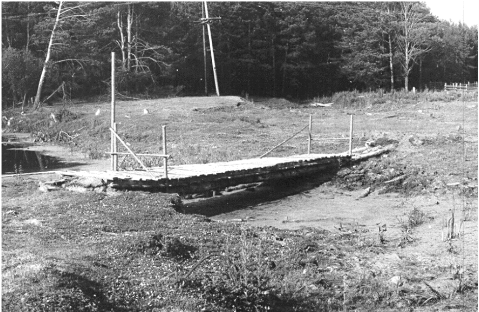
Рис. 18. Пешеходный балочный мост в д. Речапovo (Междуречье) Тарского района Омской области. Фотография 1999 г. Вид с Ю
